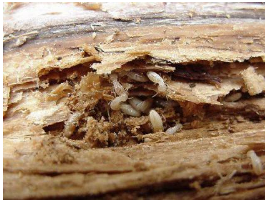
Ζημιά σε ξύλο (στοές)
