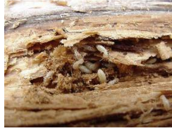
Ζημιά σε ξύλο (στοές)
